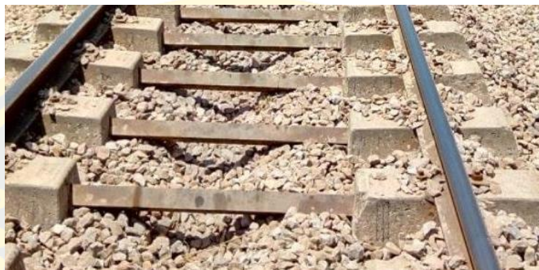
ภาพที่ 2-7 หมอนรองรางคอนกรีต Twin Block (Khan, 2018)
